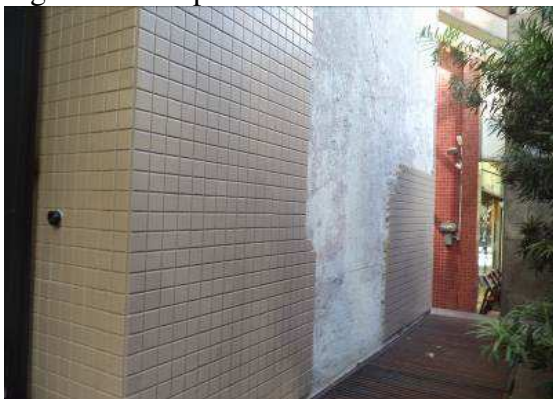
Figura 2 – Desplacamento de Revestimento Cerâmico
