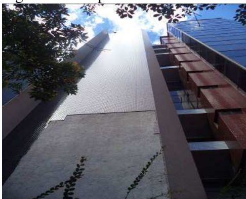
Figura 3 – Desplacamento de Revestimento Cerâmico
